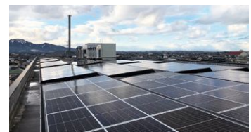
屋上に設置された太陽光発電システム
